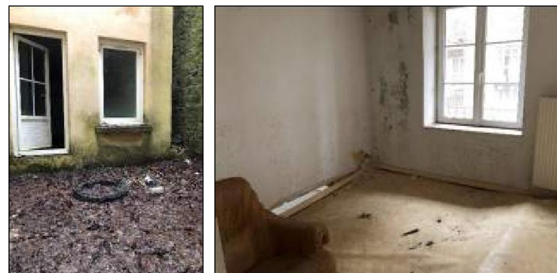
Constat des dégradations, photos prises le 23 juin 2022
