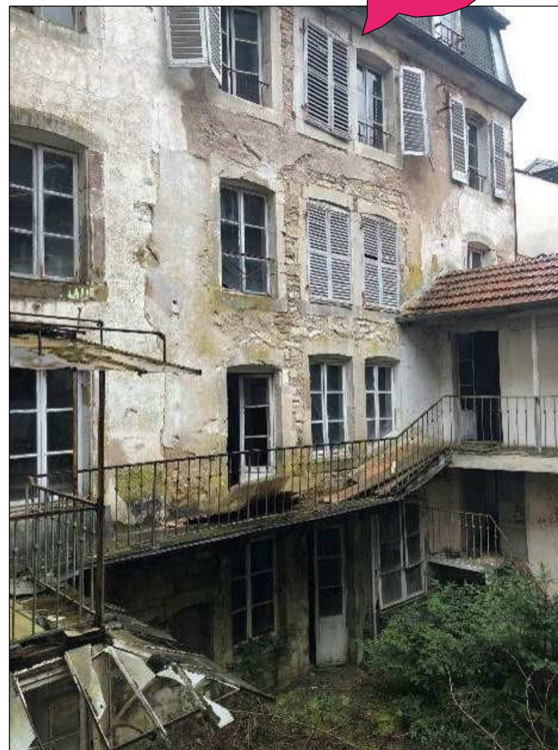
Constat des dégradations, photos prises le 23 juin 2022
